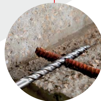
Trece cu ușurință prin beton armat.
